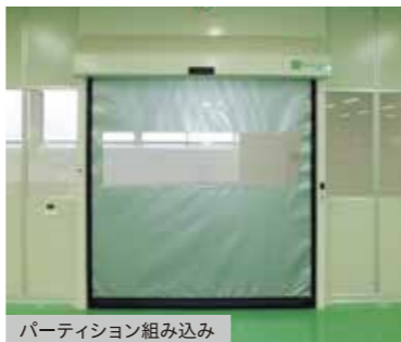
パーティション組み込み
