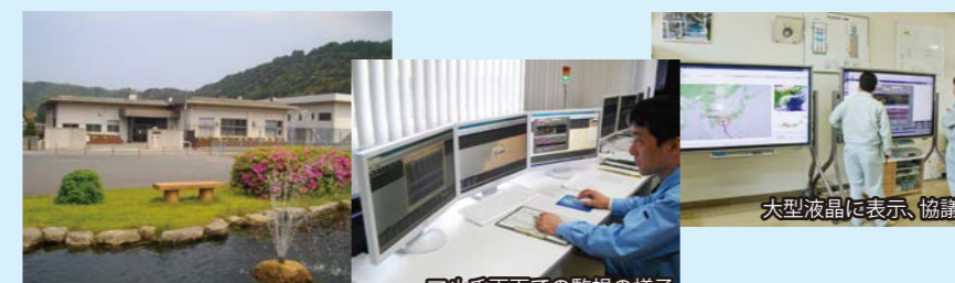
マルチ画面での監視の様子
