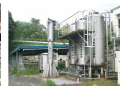
ゴミ処理場(排水処理施設)
