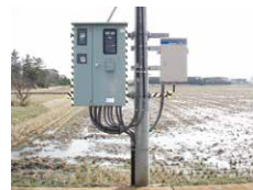
消融雪管理制御施設
