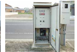
マンホールポンプ
