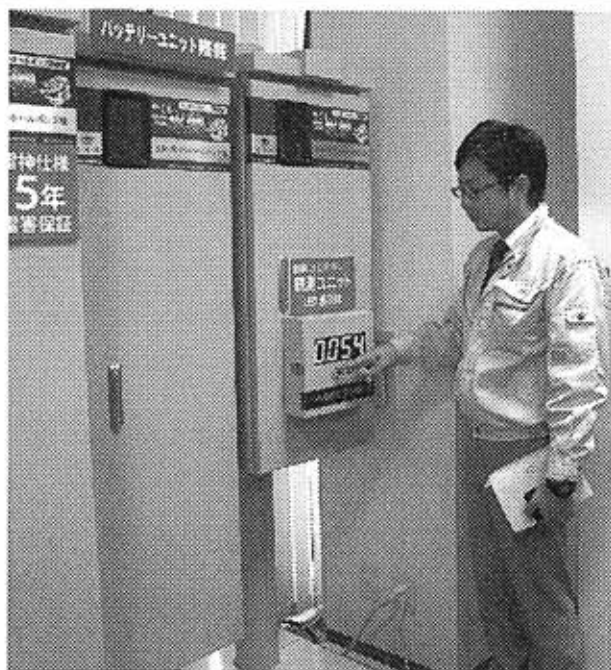
マンホールポンプ制御盤に取り 付けた放射線観測ユニット
